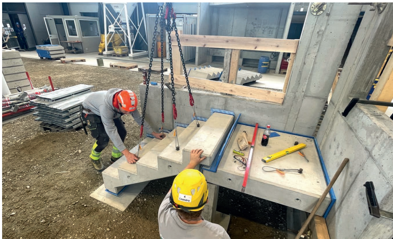
Mit Hilfe des Krans lassen sich auch schwere Treppenelemente problemlos an ihren Bestimmungsort versetzen.
